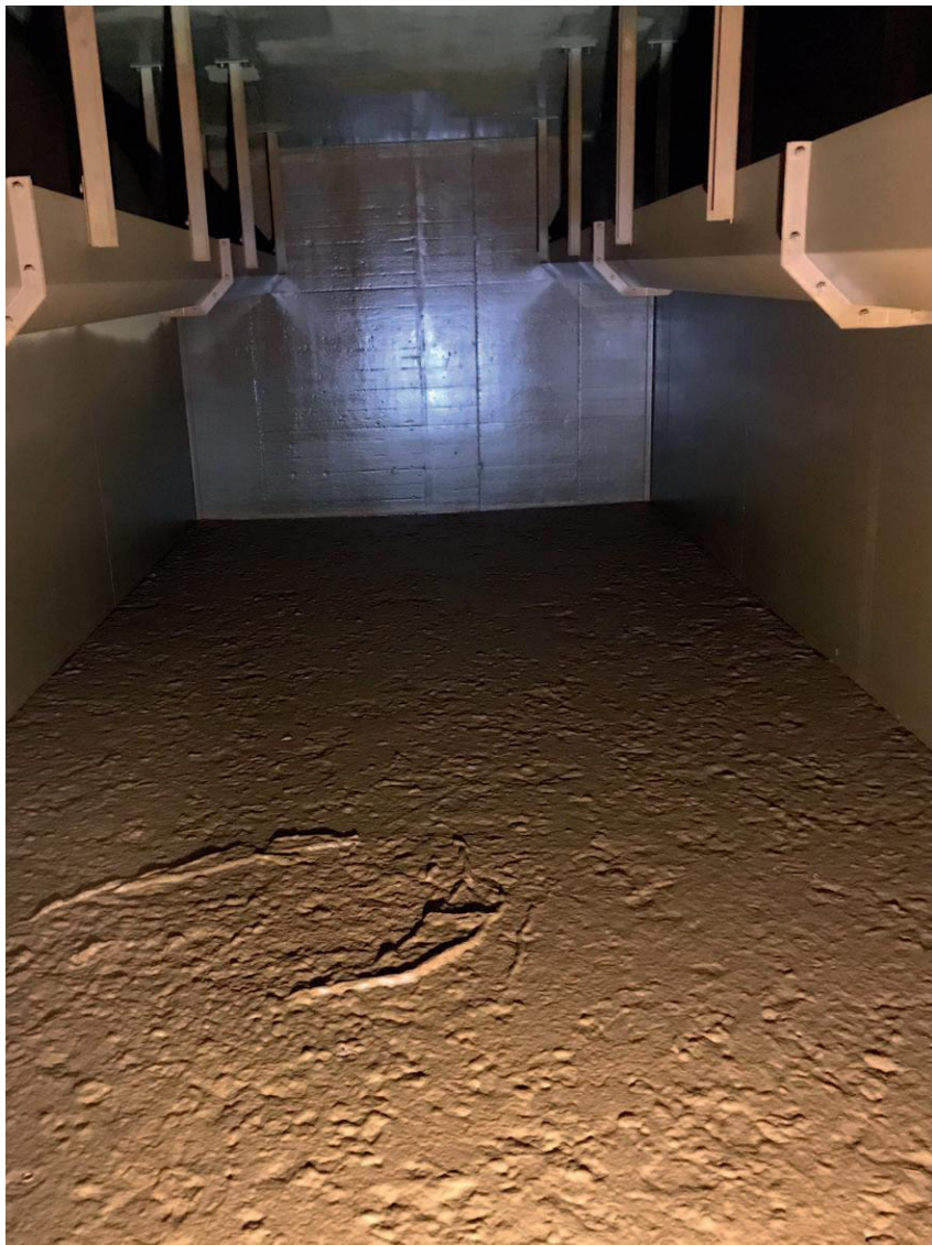
Abb. 8: Blick in die Filterkammer eines beladenen Filters
