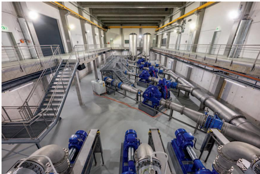
Abb. 6: Blick in die Netzpumpenhalle, im Vordergrund die drei Rückspülpumpen der Aufbereitungsfilter, im hinteren Bild die Netzpumpen und Druckstoßkessel
